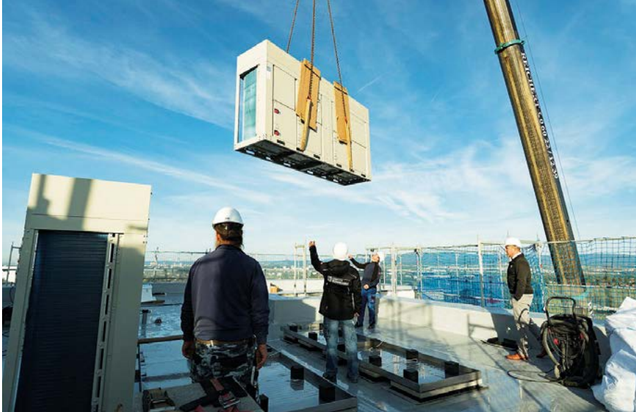
Der Einbau einer Wärmepumpe gehört zur Zukunftsvorsorge für die nachfolgende Generation.
