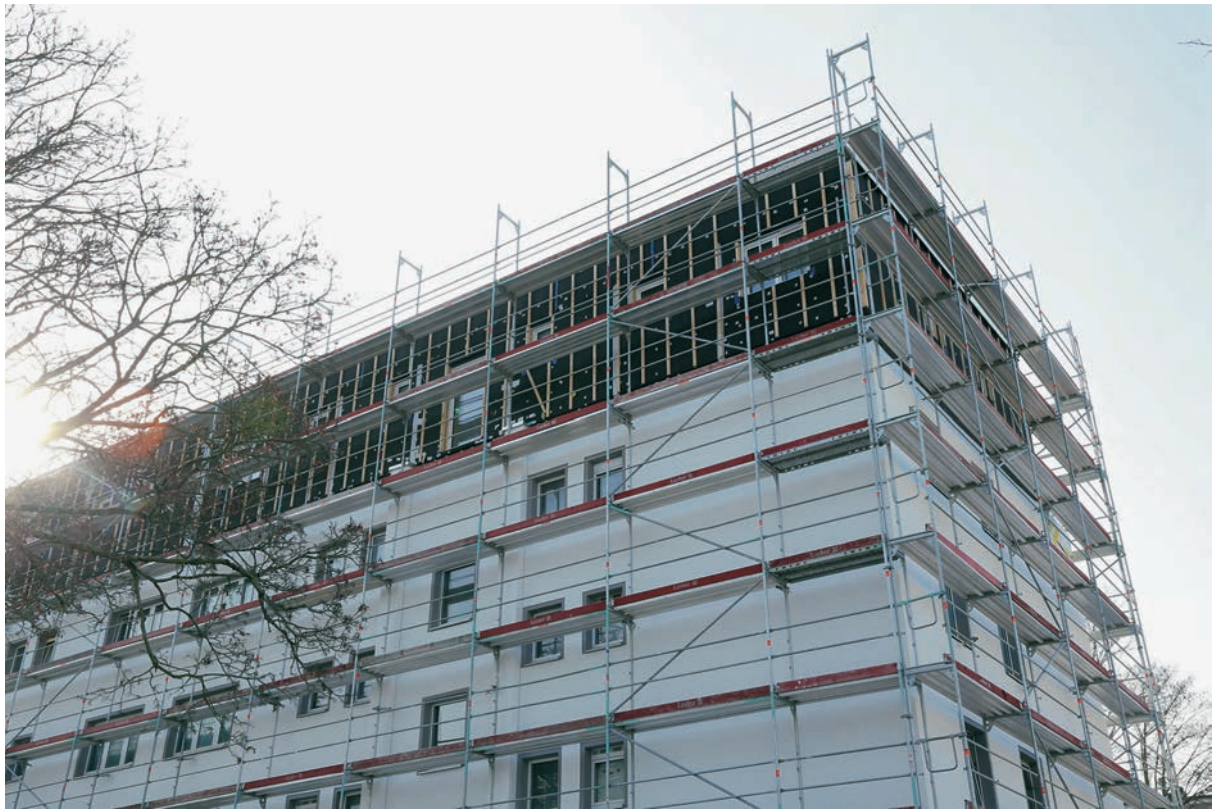
Während der Aufstockung der Fritz-Kissel-Siedlung in Frankfurt-Sachsenhausen mussten nur die Mieter:innen der obersten Stockwerke ihre Wohnungen vorübergehend gegen Hotelzimmer tauschen.
