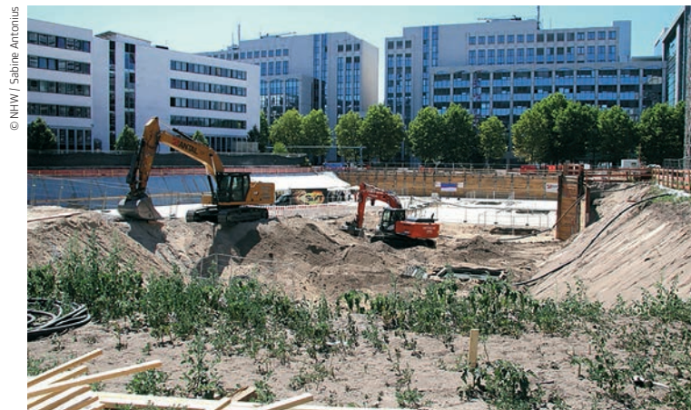
Nach fünf Jahren Bauzeit sollen die sechs Mehrfamilienhäuser in der Hahnstraße 46-48 diesen Sommer fertiggestellt werden.
